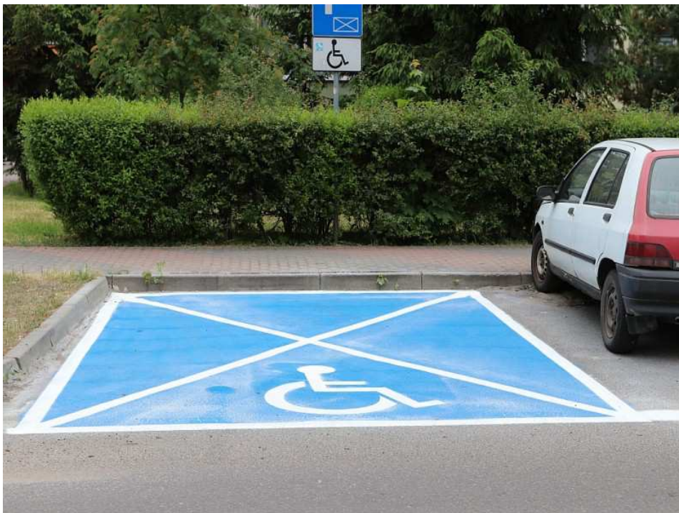
Fot. 10 Miejsce parkingowe dla osoby niepełnosprawnej obudowane krawężnikami, które utrudniają wydostanie się z tego miejsca na chodnik. Źródło: Fundacja Aktywnej Rehabilitacji.
